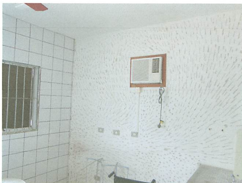
Antiga sala de vacinação, com obra inacabada e em desuso.
