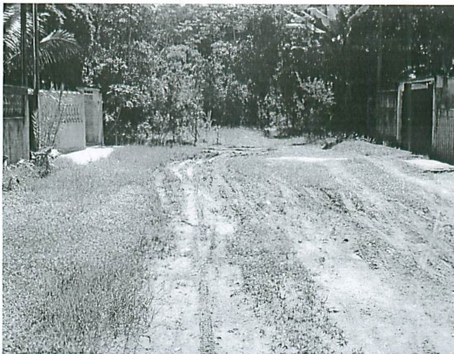
Foto 001 – Leito carroçável necessitando de nivelamento na Rua Dr. Edmundo de Queiroz no Jardim Paulista
