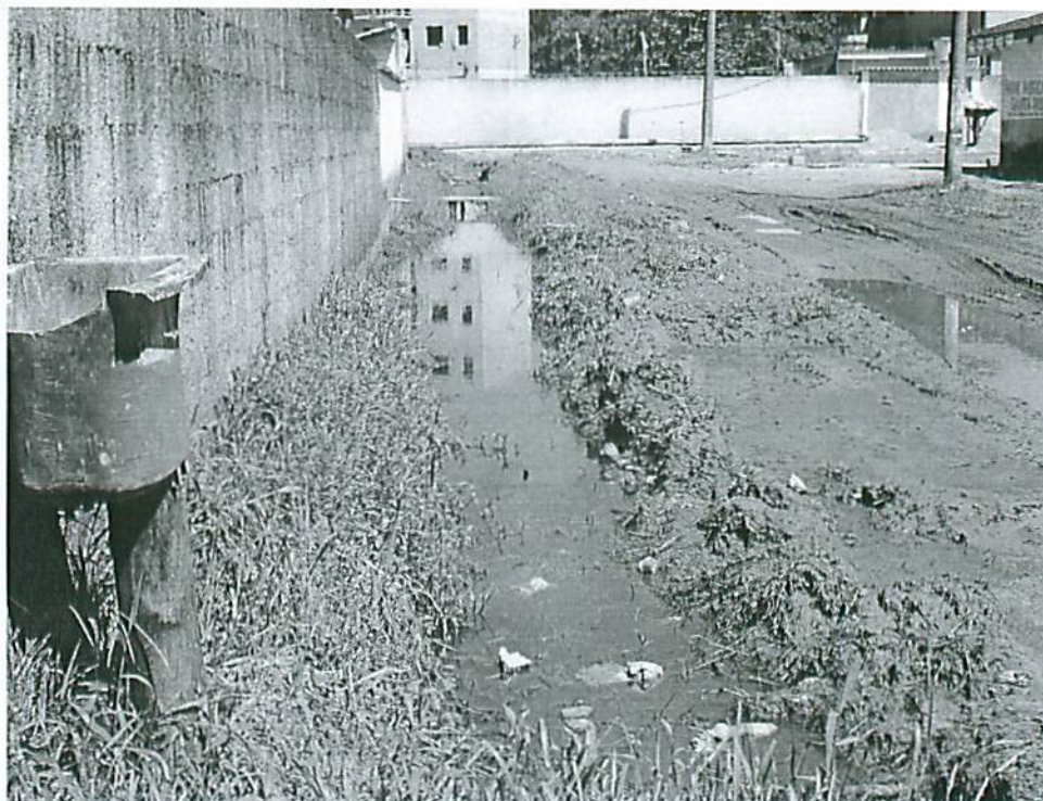
Foto 003 – Valas entupidas e com água parada servindo de criadouro do mosquito da dengue
