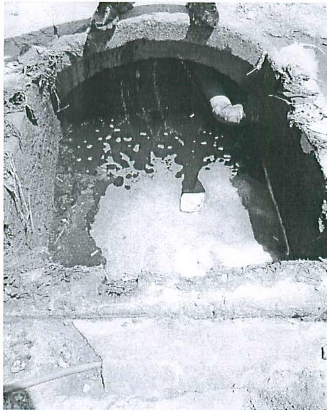
Foto 002 – Manilhas com águas paradas e sem vazão por estarem assoreadas
