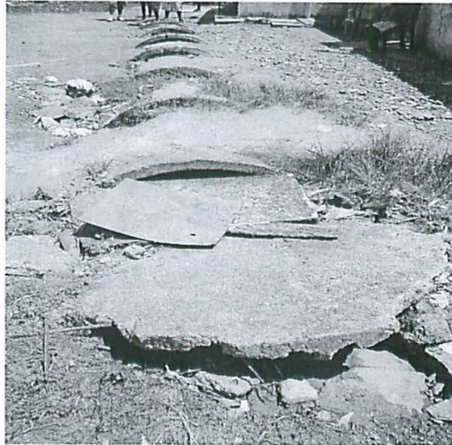
Foto 001 – Manilhas em mal estado de conservação
