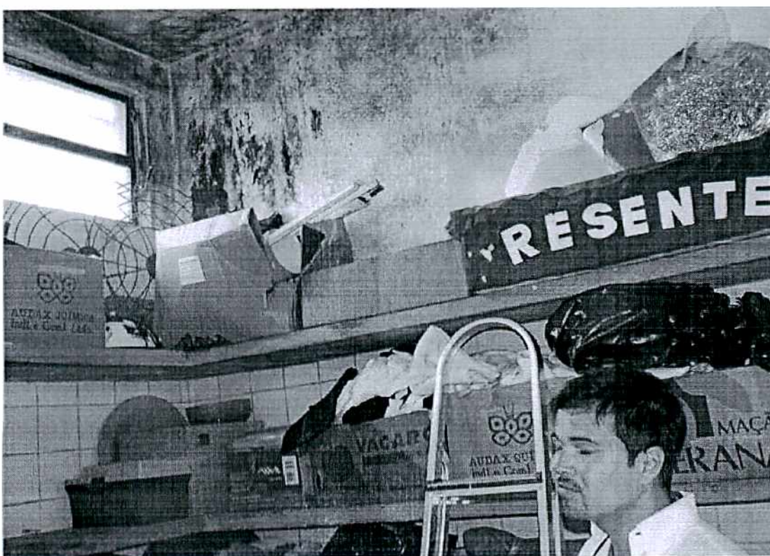
Parede da dispensa com infiltração
