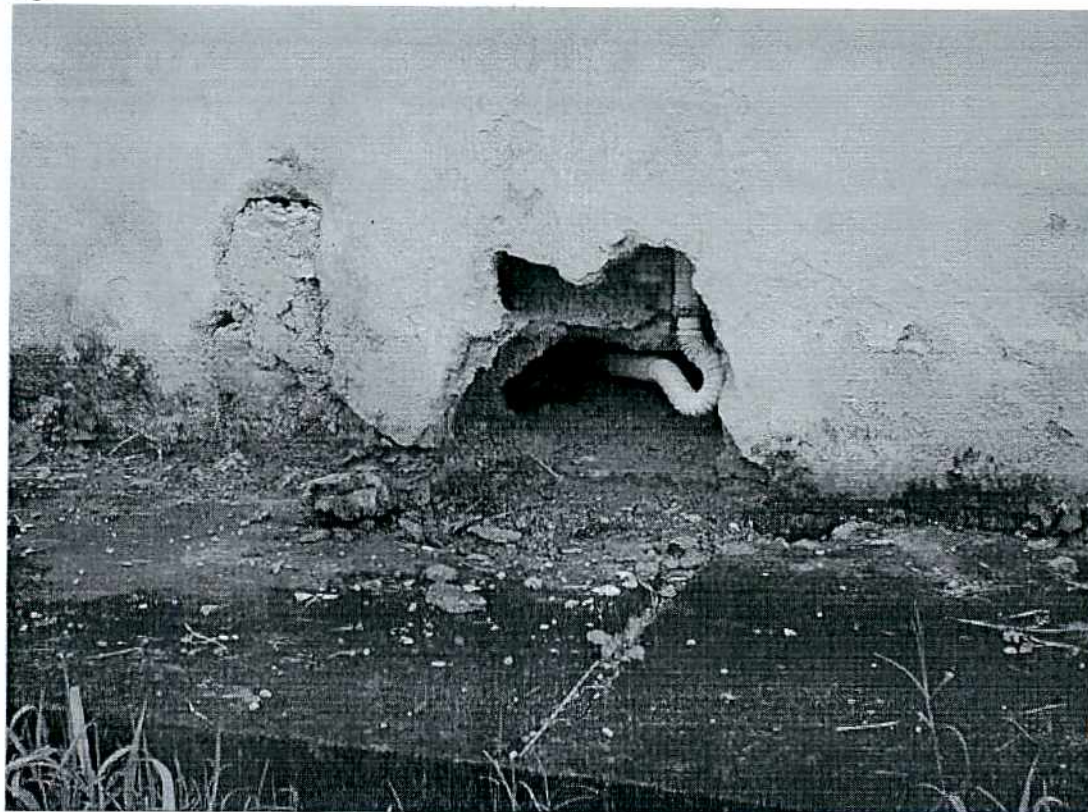
Buraco aberto e não fechado após tentativa de manutenção do encamento
