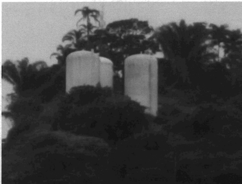
Figura 24 – Tanques de reservação para distribuição
