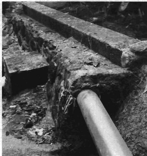
Figura 22 – Detalhe da tubulação da captação
