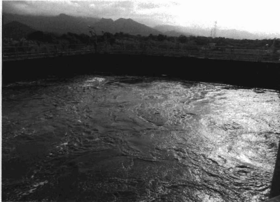
Figura 37 – Tanque de aeração
