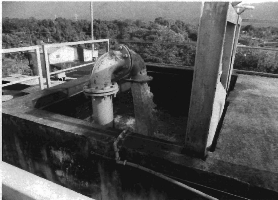
Figura 35 – Chegada do esgoto bruto
